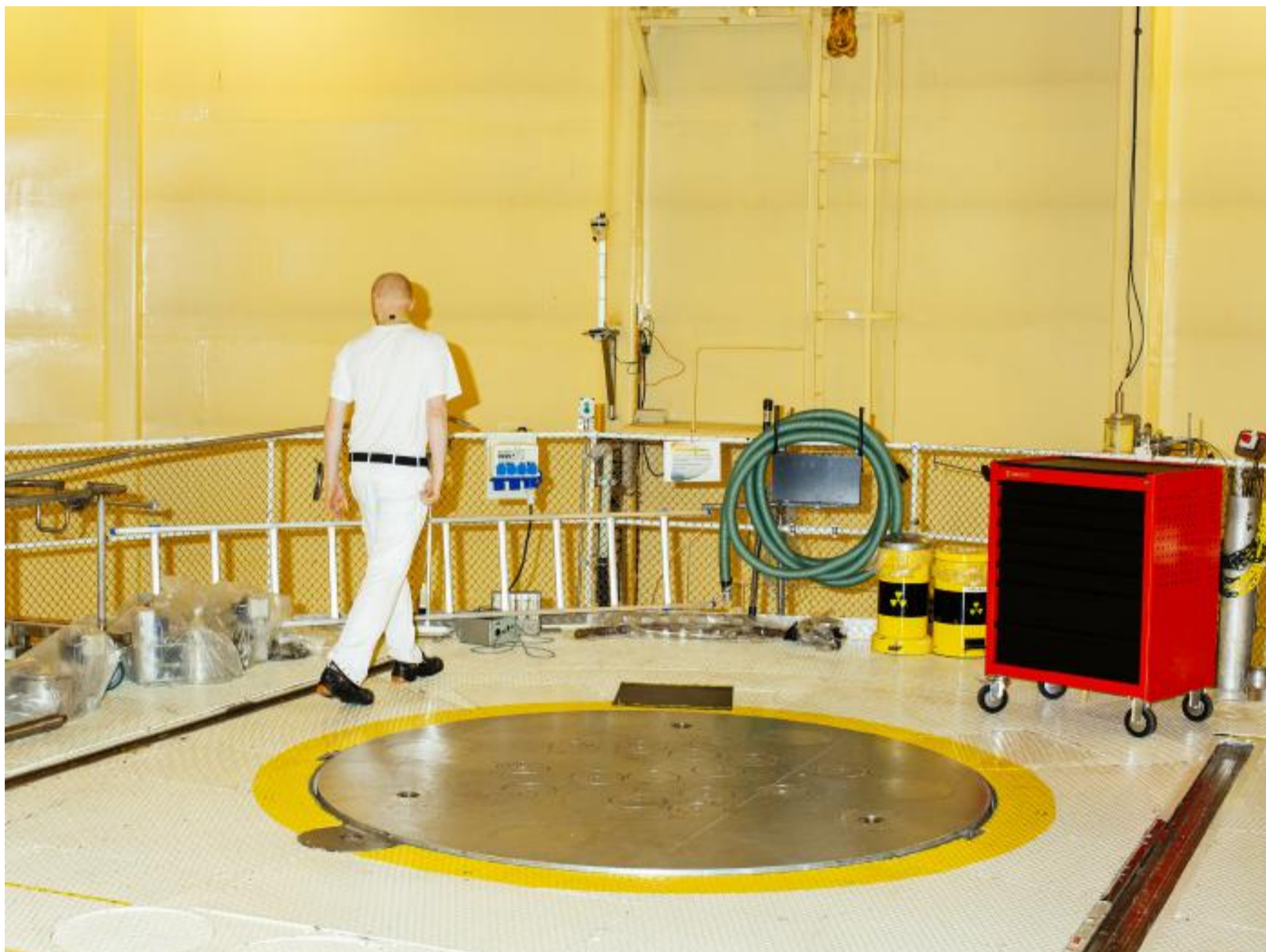
Sakens kjerne: Et par meter til høyre for senioringeniør Martin Monsen Stubberuds bein, og under noen solide meter med stål, står uranet fortsatt. Han blir antagelig blant de siste i Norge som har jobbet på en ekte atomreaktor.
